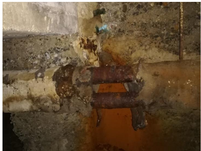
Foto 9: Particolare rivestimento dorsali impianto riscaldamento
