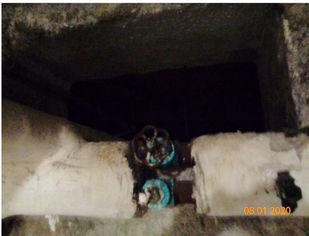
Foto 8: Particolare rivestimento dorsali impianto riscaldamento
