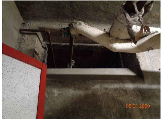
Foto 7: Particolare rivestimento impianto riscaldamento
